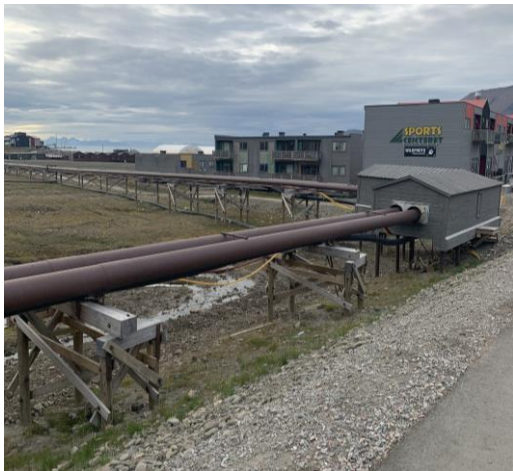
Energiinfrastruktur i Longyearbyen 2022. Foto: Katrine Wyller
