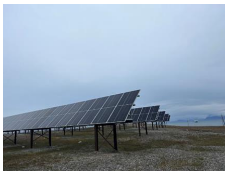
Isfjord Radio | Hybrid mikronett basert på solceller, vindkraft og energilagring | August 2023| Foto: L.Mostue
